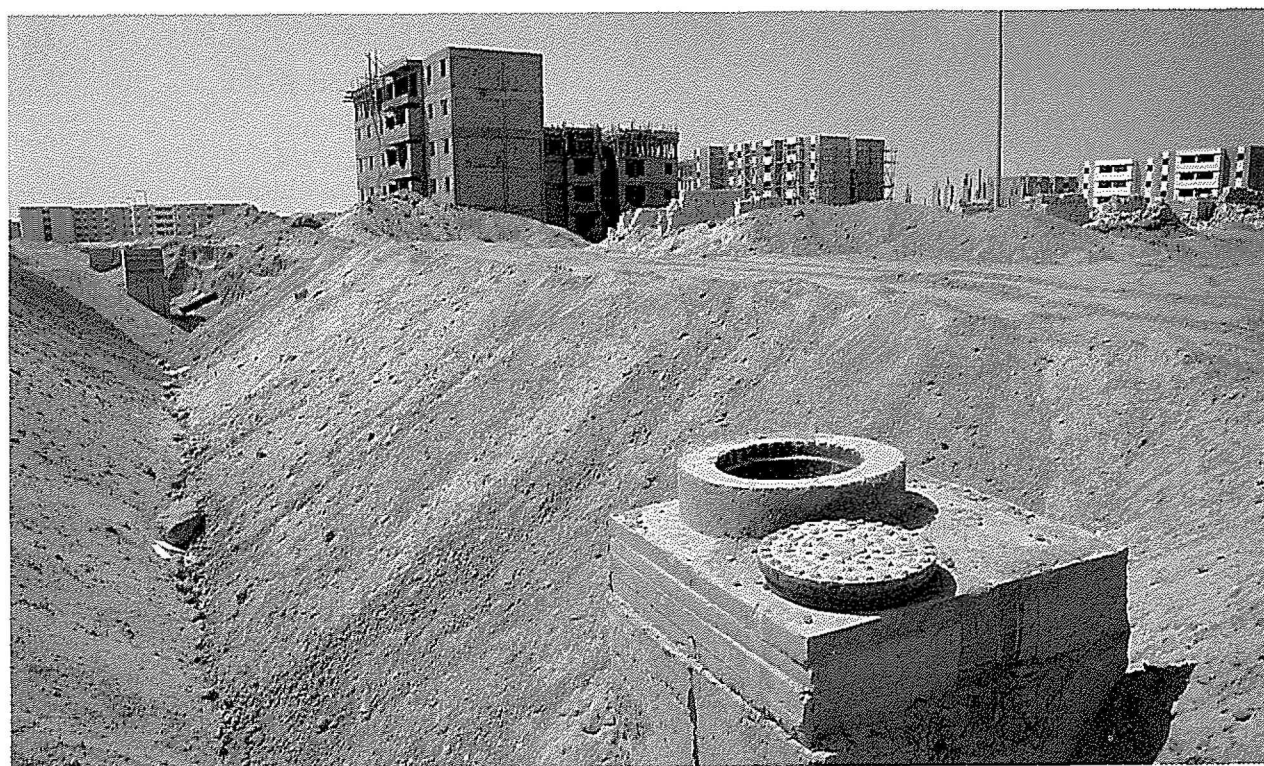
Photo 2 : New-Settlement n° 2 d'Al-Shorouk. Les infrastructures (ici une bouche d'égout) sont implantées en même temps que les cités de logements collectifs sont construites (vue vers le Nord-Ouest). Cliché : S. Jossifort, 1994.
